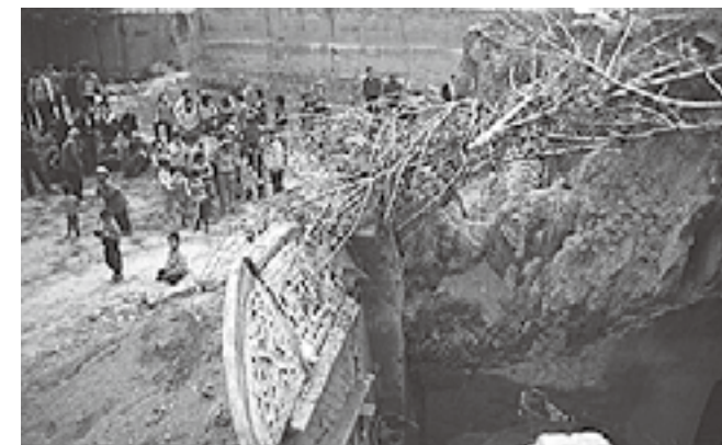
95年の水害で崩壊したヤオトン
